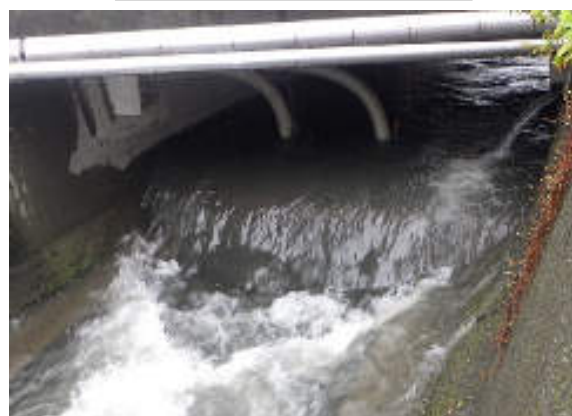
大雨による増水時の状況
