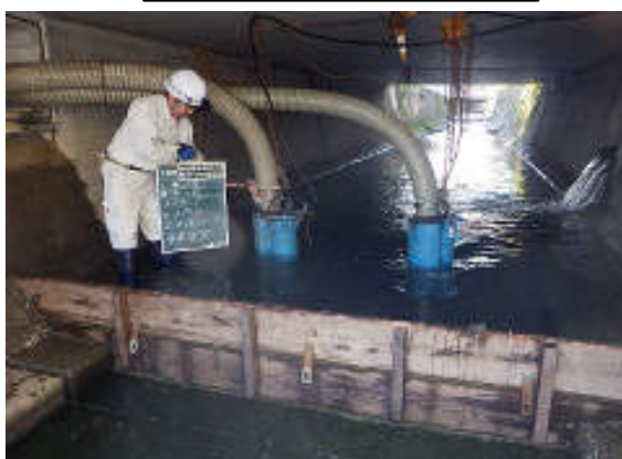
増水用予備ポンプ設置状況
